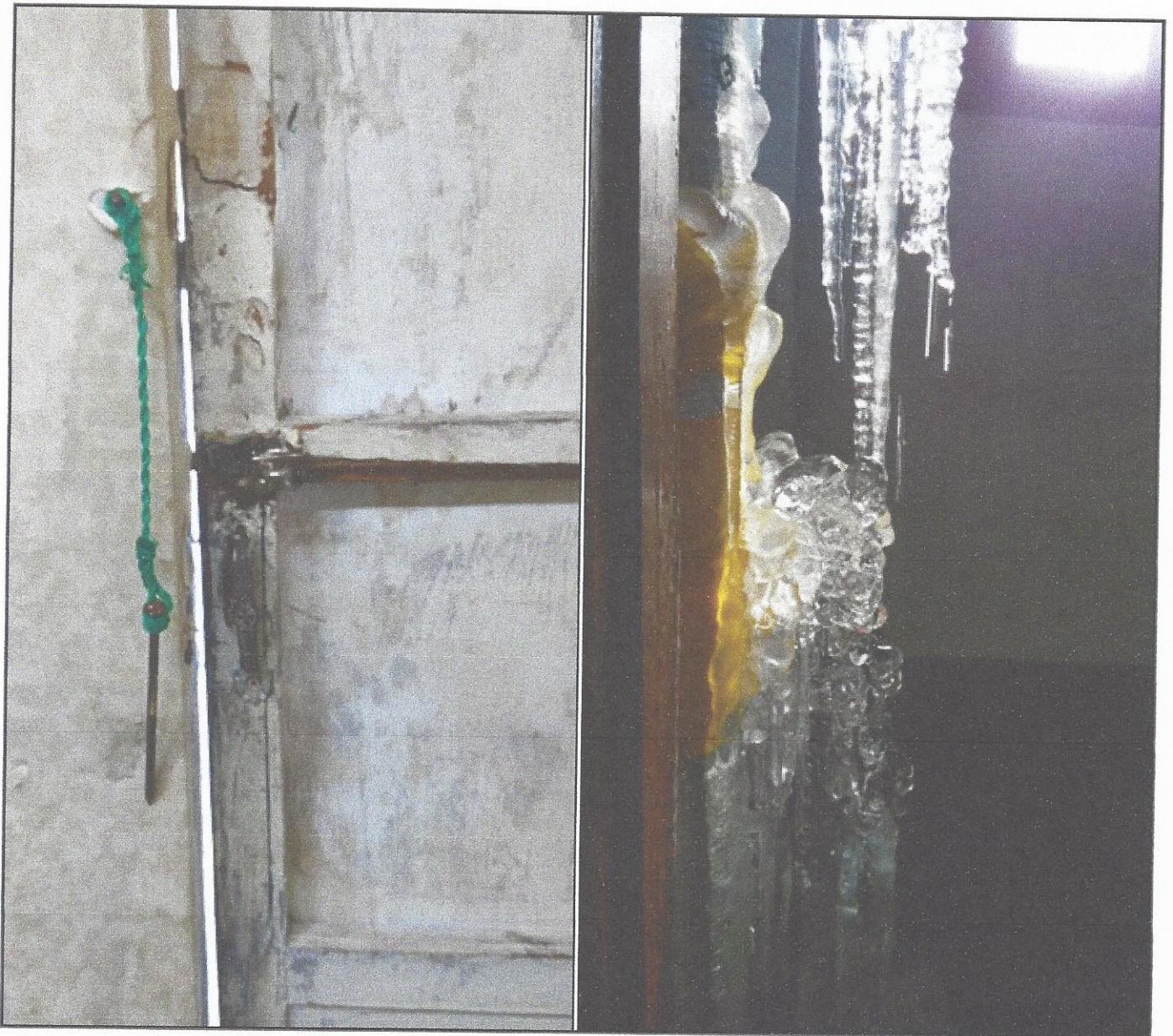
▲ 문틈...권모(63.칠성동)씨의 방문은 이가 맞지 않아 찬바람이 들어오고 있었다. / 고드름...최모(51.대신동)씨의 집 공동화장실. 수도관이 터져 물이 고드름이 되어 바닥까지 이어지고 있다. / 사진. 평화뉴스 김지연 인턴기자
